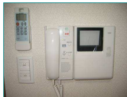
■ 緊急通報ボタン
